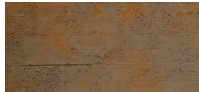
M-182 Rusty Grated Concrete Panel Panel Hormigón Rayado Oxidado
